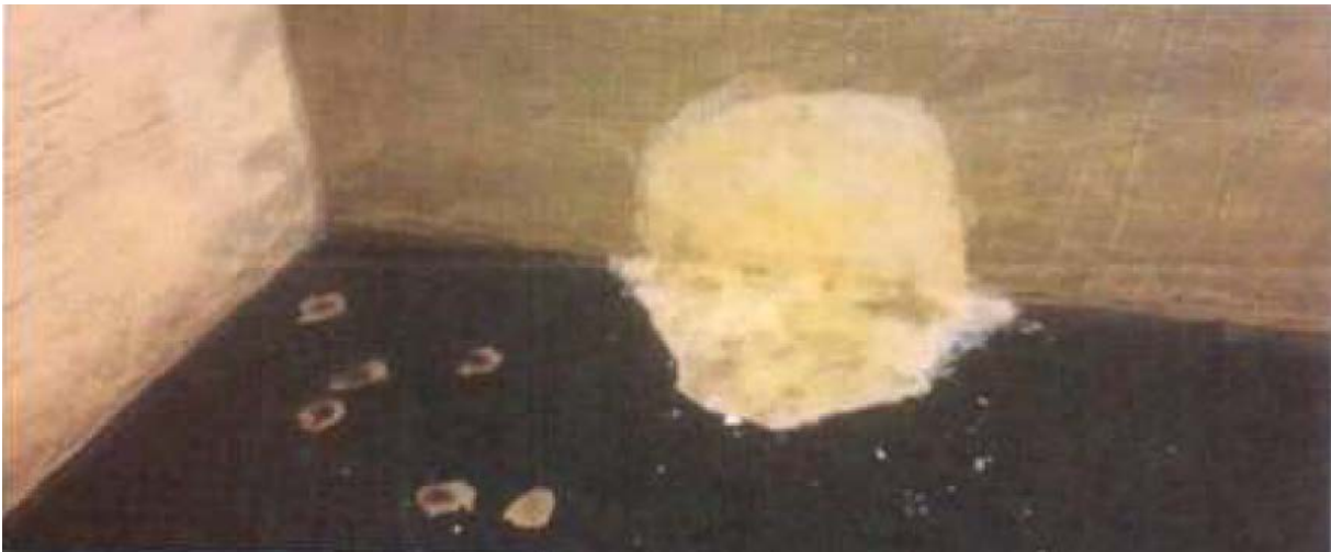
Zustand vom Boden in der Trinkwasserkammer "Teufelsfriedhof"
