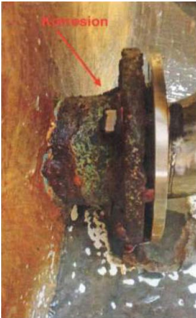
Zustand der Rohre in der Trinkwasserkammer "Teufelsfriedhof"
