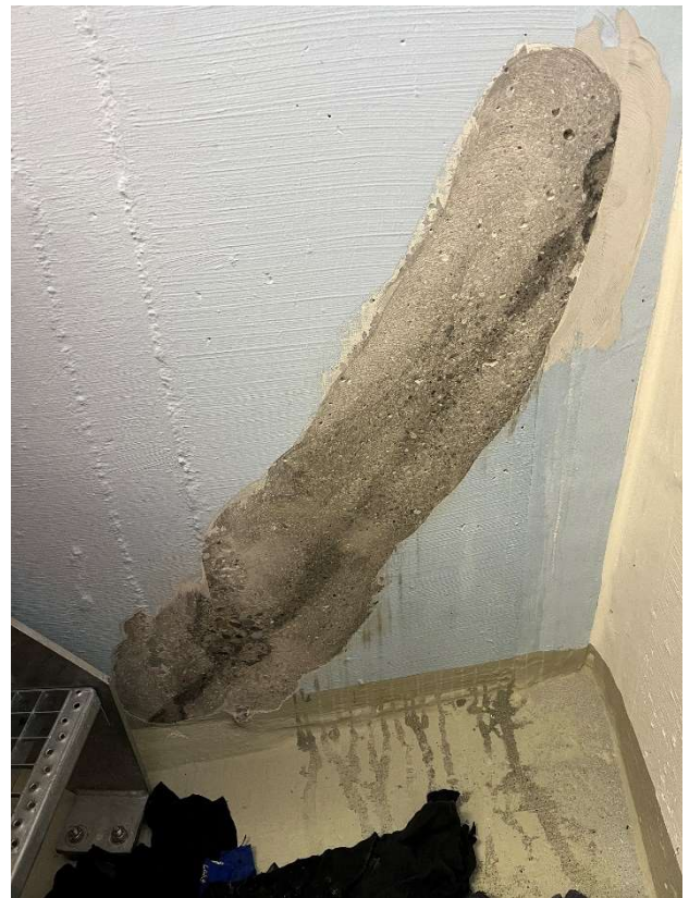
Abbildung 17: Reparatur Riss WK Bovel
