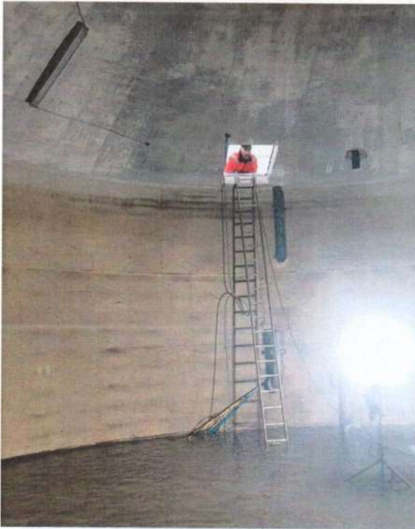
Abbildung 13: 2.05 Einstieg in die Trinkwasserkammer
