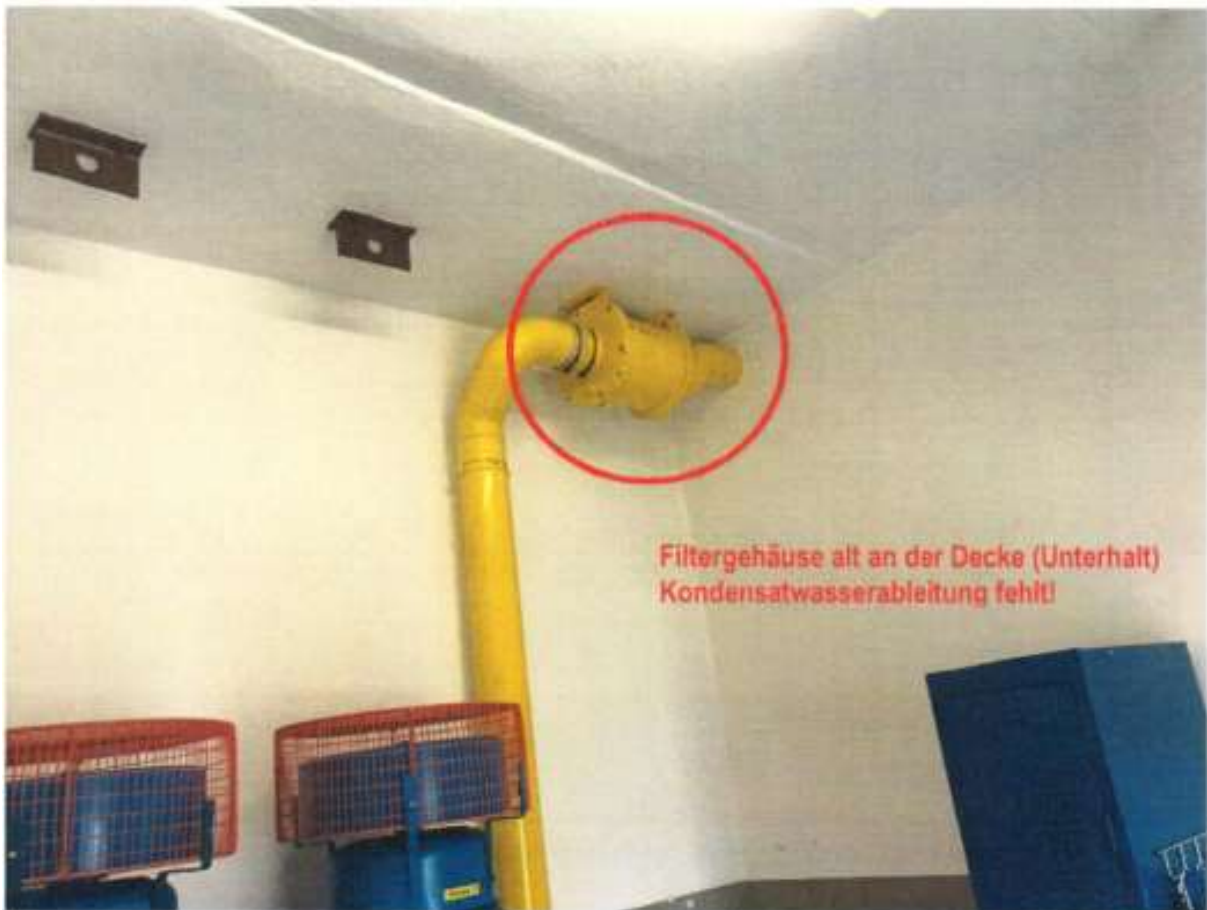
Abbildung 7: 2.11 Belüftung Trinkwasserkammern (1x für beide Kammern)
