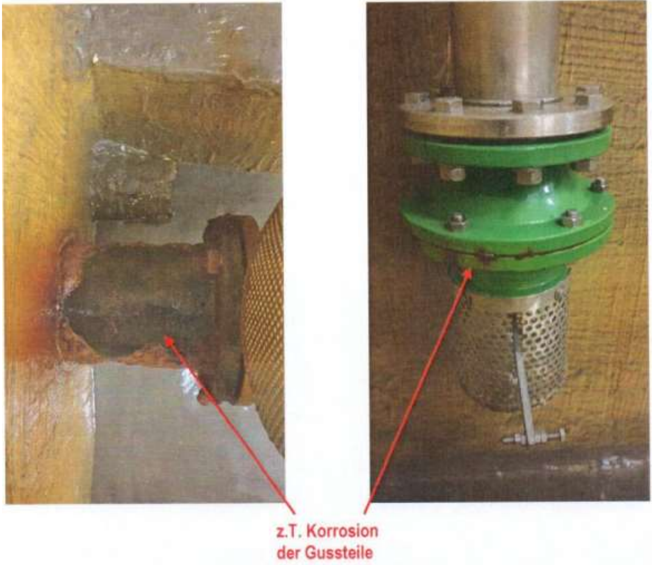
Abbildung 1: 2.06 Zustand der Rohre und Halterungen in der Trinkwasserkammer links
