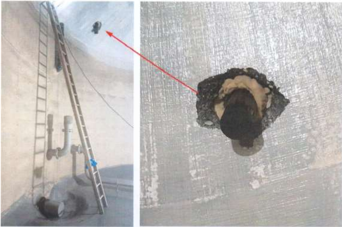
Abbildung 15: 2.09 Zustand der Decke in der Trinkwasserkammer
