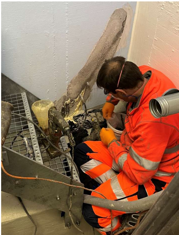
Abbildung 18: Reparatur Riss WK Bovel
