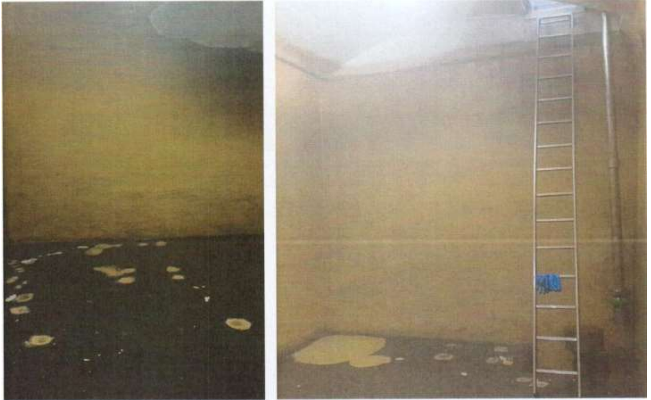
Abbildung 2: 2.07 Zustand vom Boden in der Trinkwasserkammer links
