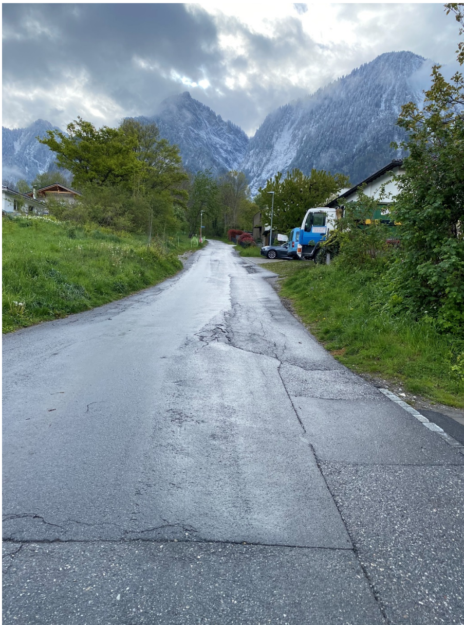
Bestehende Bannholzstrasse mit Belagsflicken, Rissen und Spurrinnen
