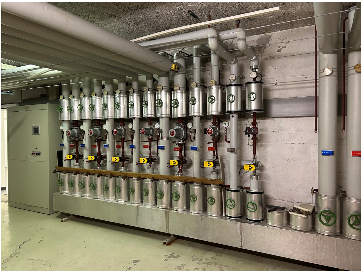
Links Elektroschrank Baujahr 2005 Mitte - Rechts Zuleitungen zu den Gebäudeteilen
