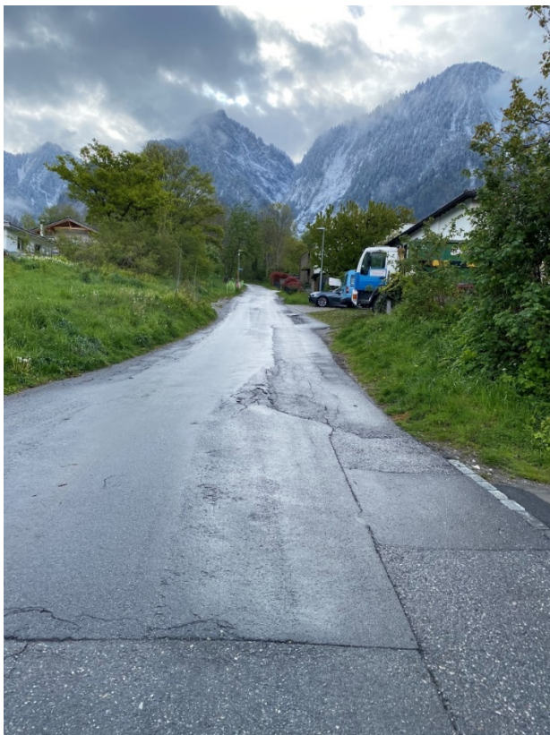
Bestehende Bannholzstrasse mit Belagsflicken, Rissen und Spurrinnen
