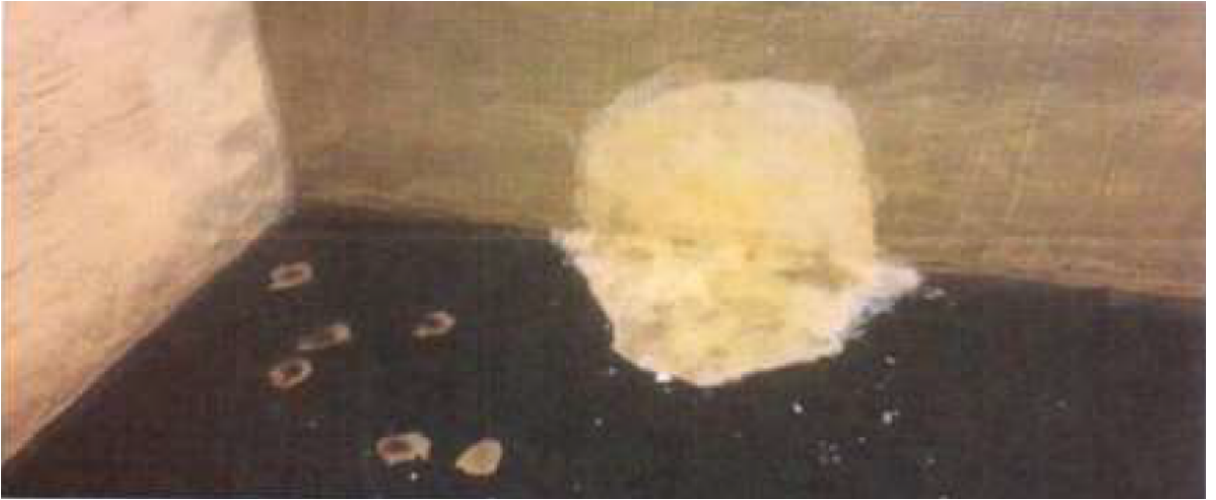
Zustand vom Boden in der Trinkwasserkammer "Teufelsfriedhof"
